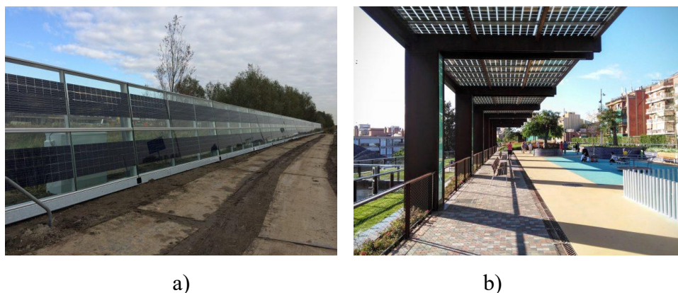
Rys. 2. Montaż modułów dwustronnych (bifacjalnych) na specjalnych konstrukcjach wsporczych: a) montaż w pozycji pionowej w układzie wschód-zachód, b) montaż w pozycji poziomej jako zadaszenie - SolarInnova 6 .
